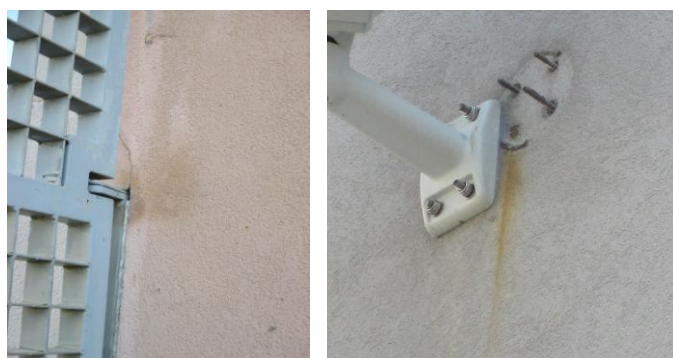
Figura 2.11. Exemplos de manchas de oxidação de elementos metálicos (imagem à direita da autoria de AMARO, 2011)
