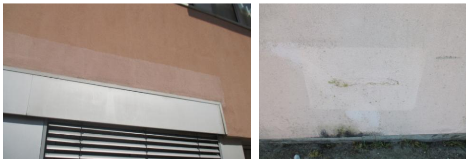
Figura 2.16. Exemplos de pinturas contrastantes com as cores originais, resultantes de reparações pontuais
