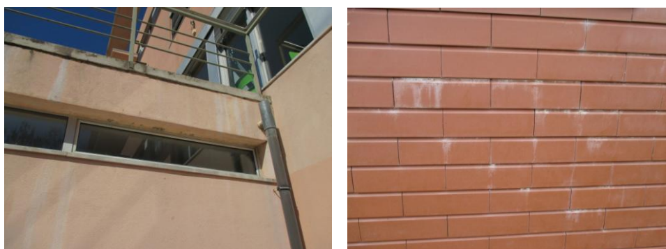
Figura 2.9. Exemplos de eflorescências em fachadas revestidas por ETICS
