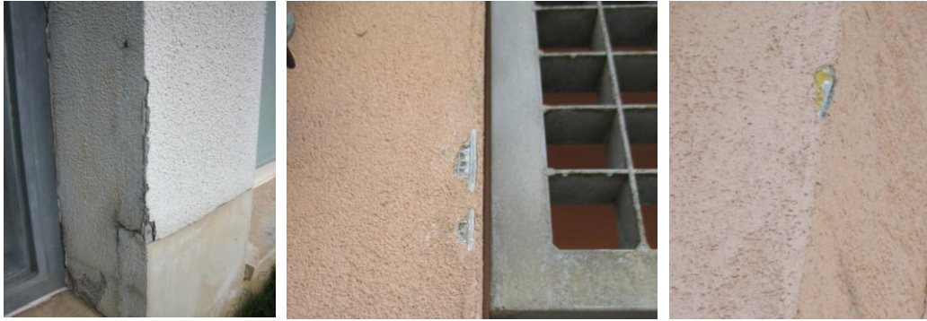
Figura 2.5. Fissuração do recobrimento da cantoneira de reforço (imagem à esquerda da autoria de AMARO, 2011) e destacamento do acabamento na aresta, observando-se parte da cantoneira de reforço (ao centro e à direita)
