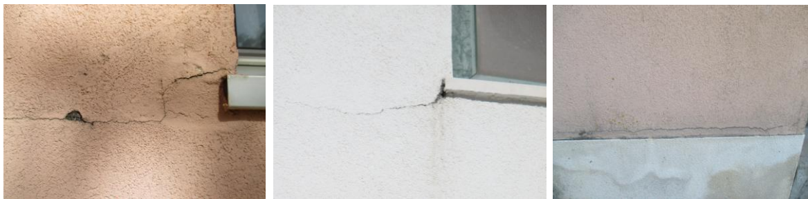
Figura 2.4. Exemplos de fissuração em sistemas ETICS
