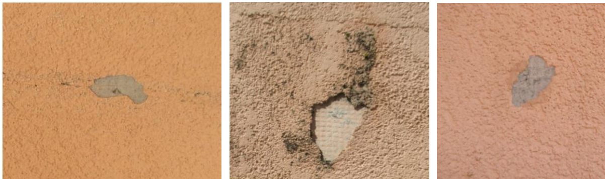
Figura 2.7. Exemplos de destacamentos em fachadas revestidas com ETICS
