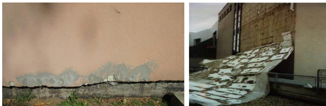
Figura 2.8. Exemplo de perda de aderência das placas isolantes ao suporte, com o substrato à vista na parte inferior (à esquerda) e exemplo de descolamento generalizado do sistema ETICS (imagem à direita da autoria de MOREIRA et al. , 2015)
