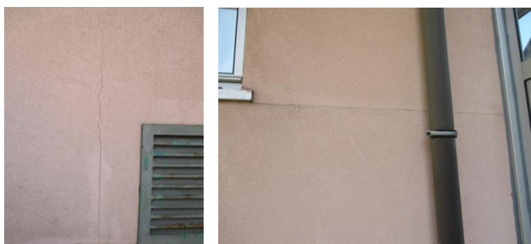
Figura 2.19. Exemplos de fissuração nas juntas
