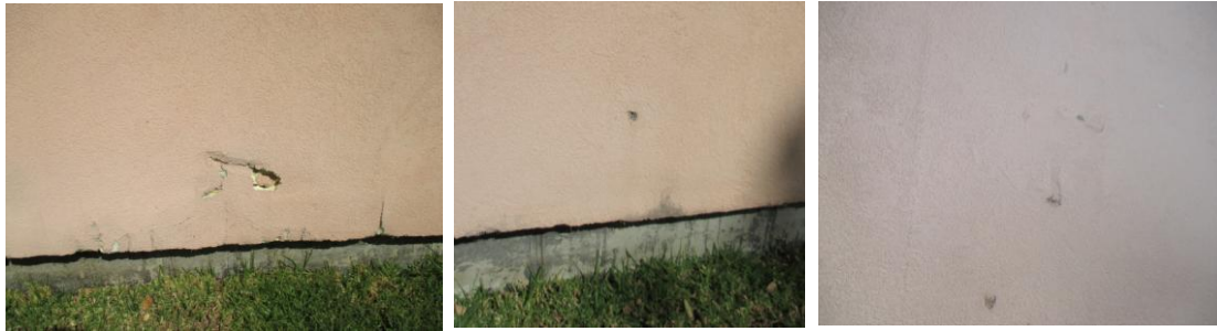
Figura 3.28. Exemplos de lacunas de material observadas em duas das fachadas excluídas da amostra
