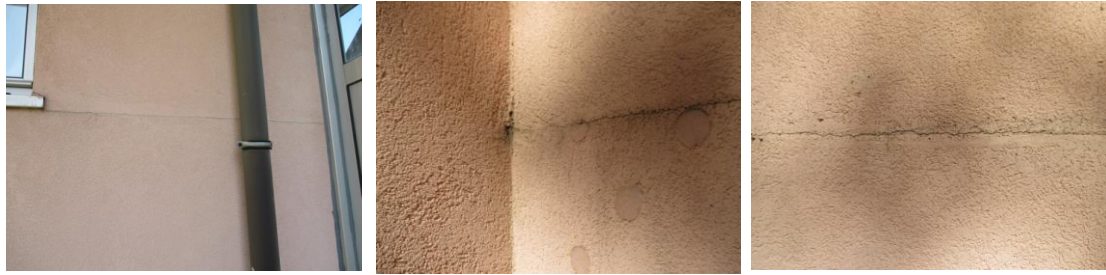
Figura 3.27. Anomalias nas juntas presentes nas duas fachadas
