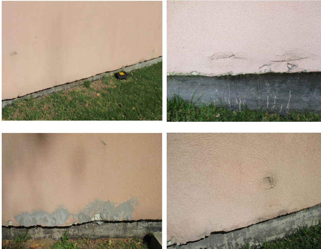
Figura 3.25. Descolamento das placas de isolamento térmico do suporte, agravado pela inexistência de remate inferior
